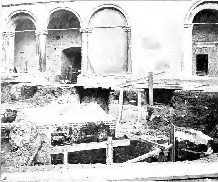
Fig. 45* Ansicht des südlichen Arkadentraktes des Wawelschlosses mit bloßgelegten Teilen des alten Baues
